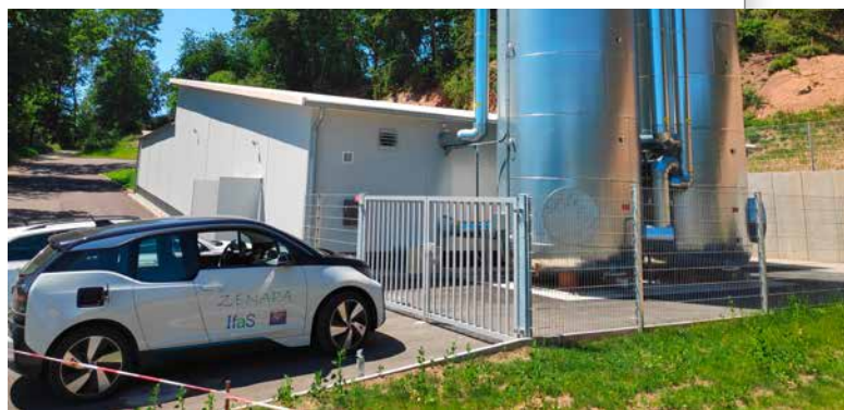
Heizzentrale mit Pufferspeicher
